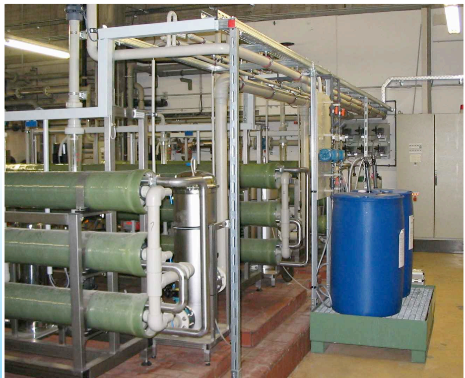
Bild oben und rechts: Kesselspeisewasseraufbereitung der Universität Mainz, Umkehrosmose 3 x 10 m 3 /h, permeatgestuft mit vorgeschalteter Härtestabilisierungsdosierung
